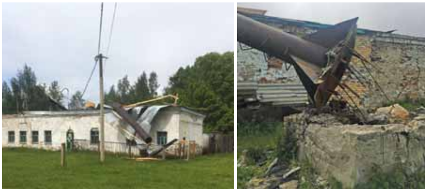
Рис. 18. Авария газифицированной котельной сельского поселения Богатырево ООО «Регион»
