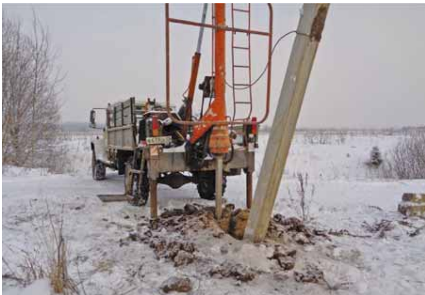
Рис. 10. Авария на предприятии АО «Газпром газораспределение Ленинградская область»
