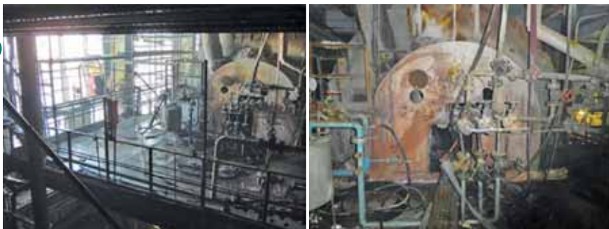
Рис. 4. Авария в цехе № 18 по производству сложных минеральных удобрений. при остановке производства нитроаммофоски
