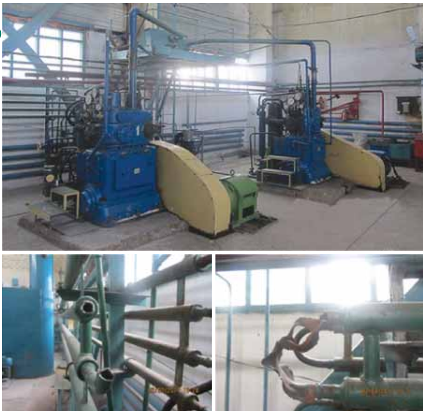
Рис. 1. Авария на площадке воздухоразделительной установки получения кислорода
