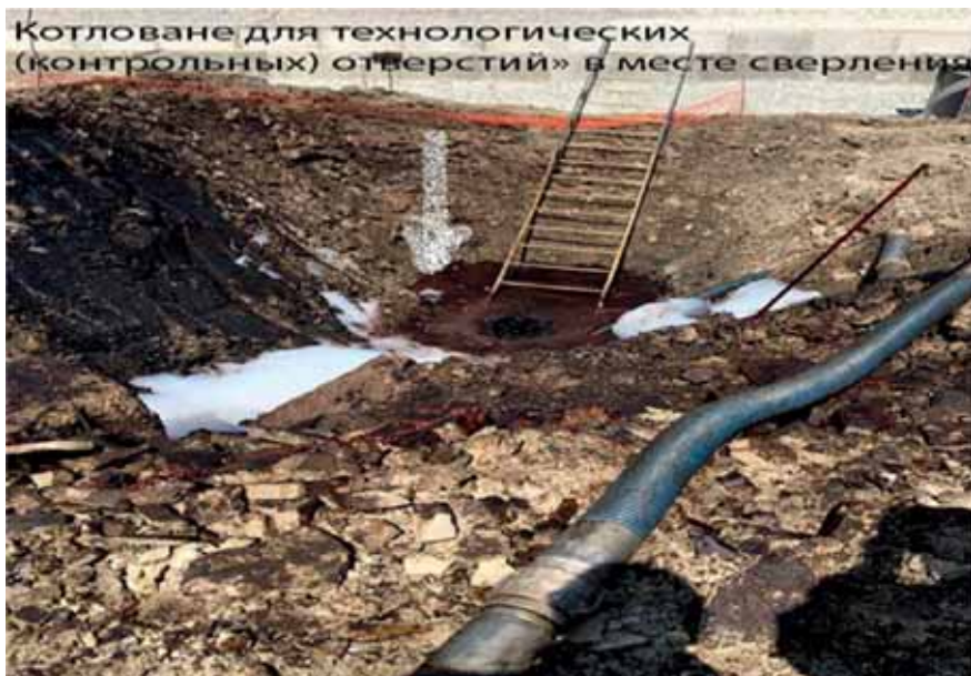
Рис. 26. Авария на площадке «Грушевая» парка резервуарного ПК «Шесхарис»
