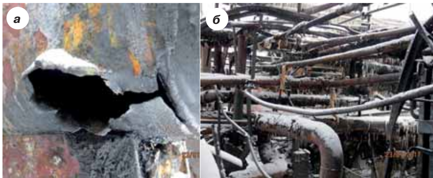
Рис. 15. Место аварии: а — разрушенный участок трубопровода; б — общий вид наружной установки после аварии
