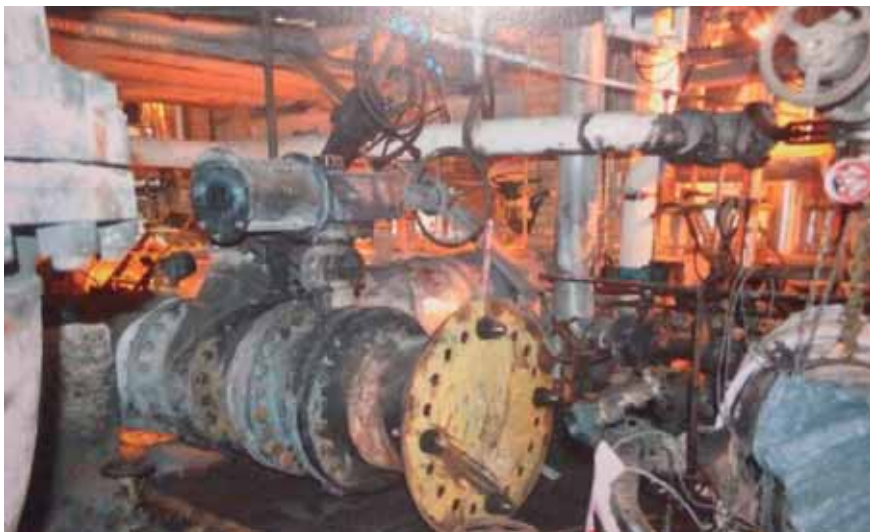
Рис. 14. Общий вид поврежденного оборудования
