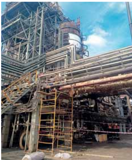
Рис. 20. Общий вид колонны и эстакады после аварии
