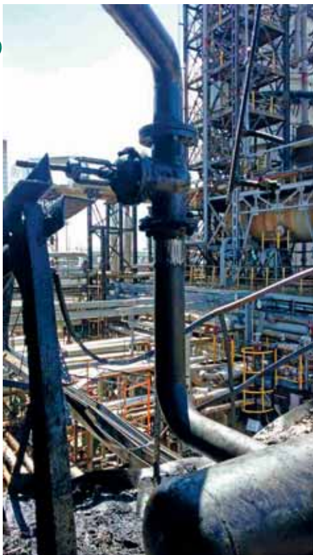
Рис. 23. Общий вид установки после аварии
