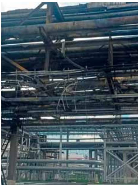
Рис. 21. Общий вид эстакады после аварии
