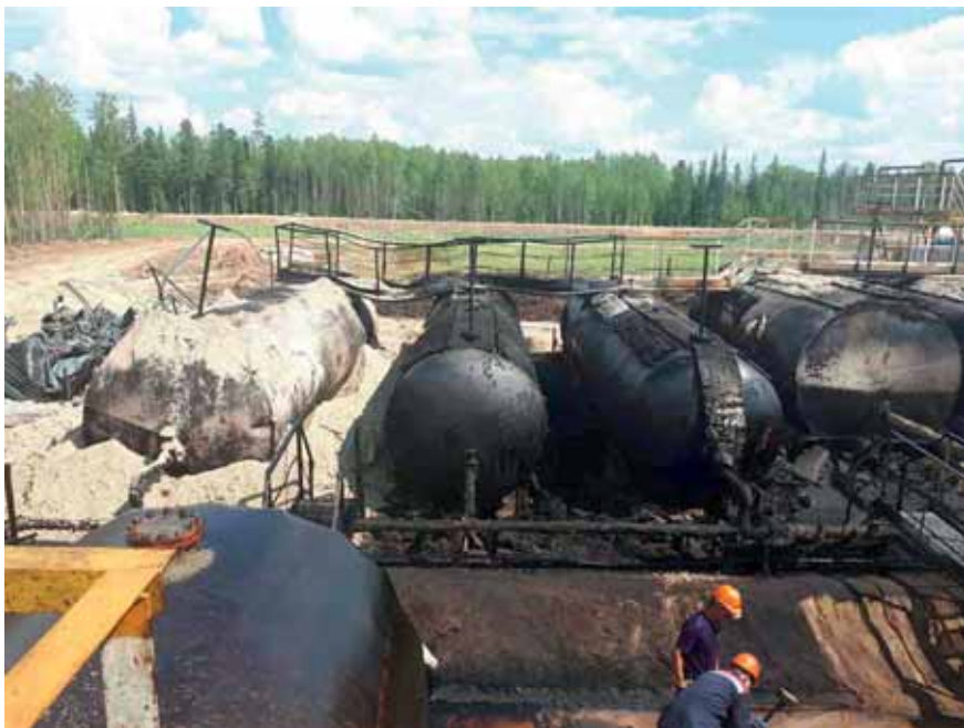
Рис. 13. Место возгорания нефти на площадке горизонтальных резервуаров
