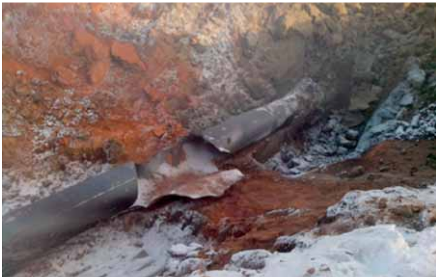
Рис. 5. Вид разрушенного магистрального газопровода
