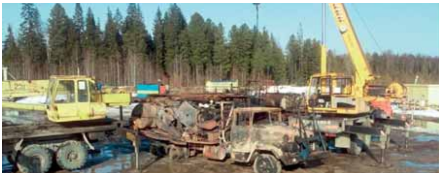
Рис. 10. Место аварии на ОПО «Фонд скважин»
