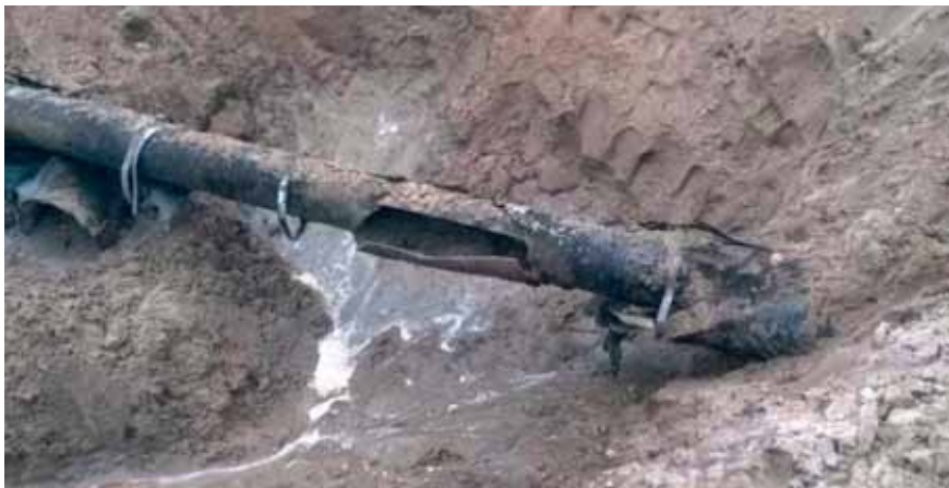
Рис. 12. Место разгерметизации подземного трубопровода.
