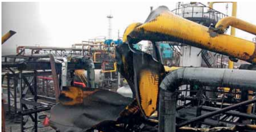
Рис. 11. Разрушение трубопровода на Усинского ГПЗ.
