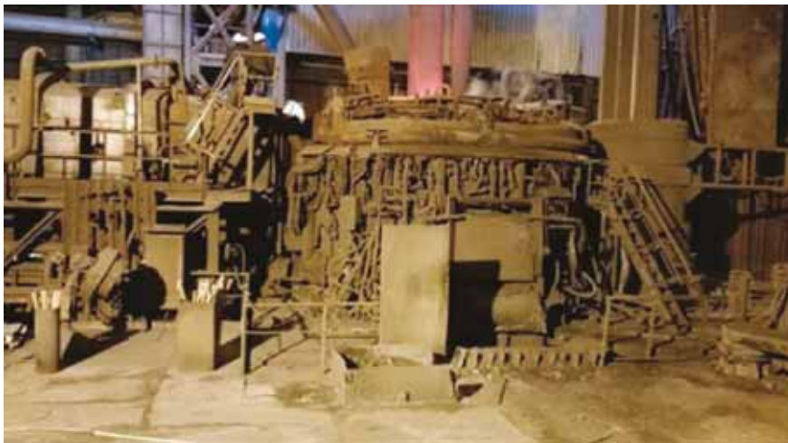
Рис. 7. Место аварии в электроплавильном цехе ПАО «Ашинский металлургический завод»
