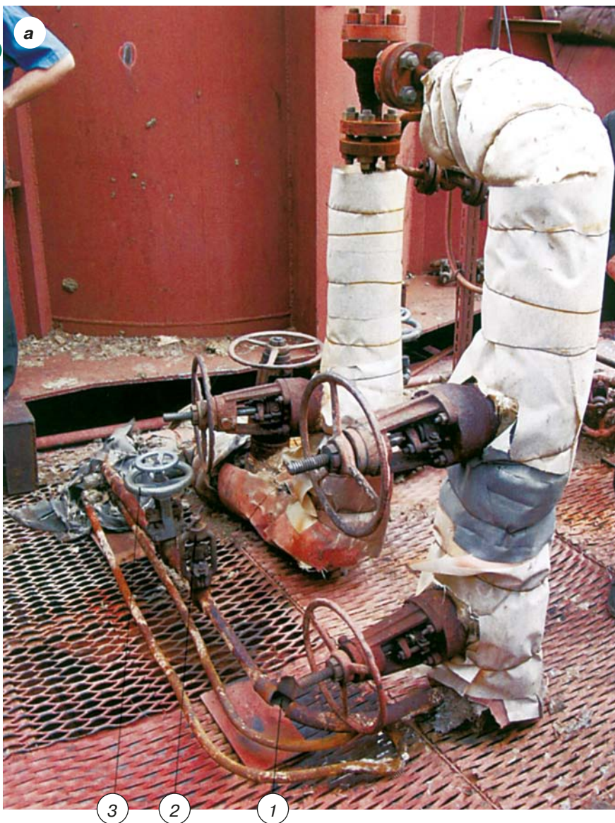
Рис. 10. Место несчастного случая в ОАО «Салаватнефтеоргсинтез»: а – клапан-регулятор уровня на линии питательной воды: 1 – место разрыва трубопровода, 2 и 3 – вентили на байпасной линии; б – байпасная линия: 1 – место разрыва, 2 и 3 – вентили; в – место разрыва трубопровода
