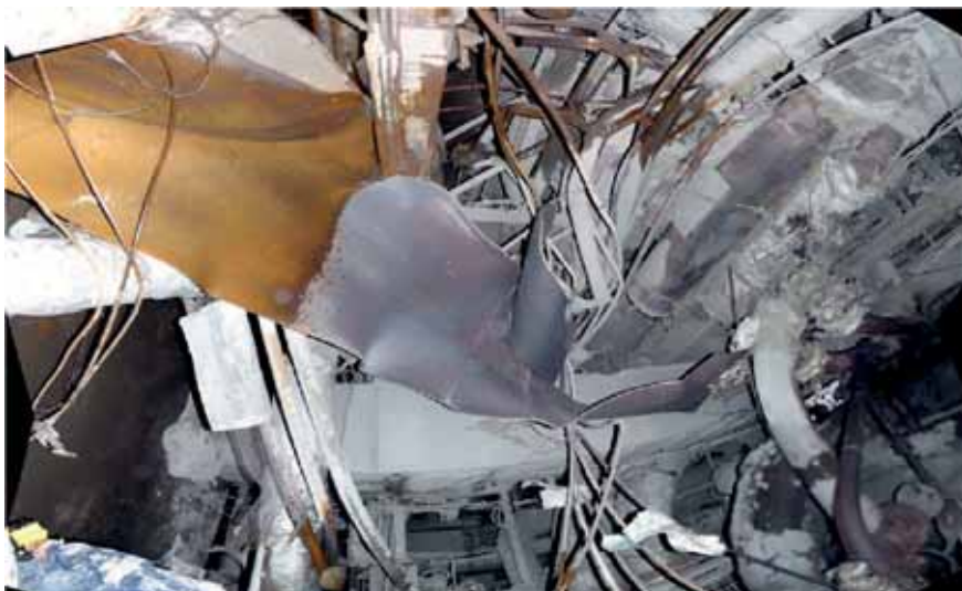
Рис. 37. Вид разрушенного трубопровода
