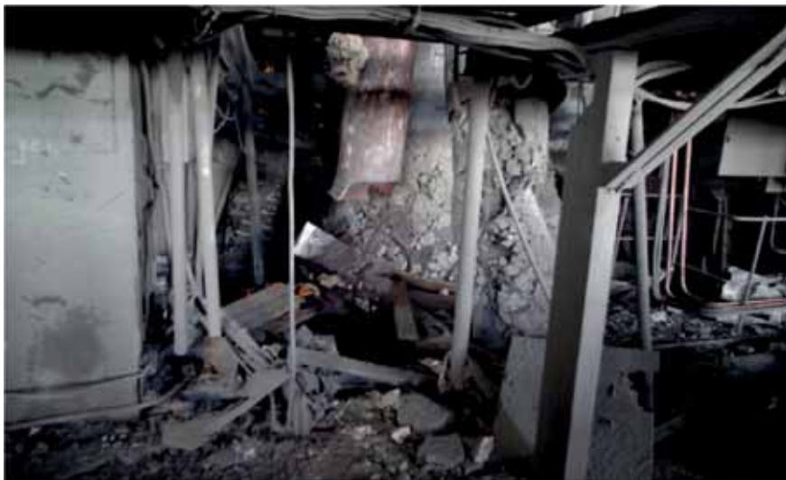
Рис. 38. Вид разрушенной опорно-подвесной системы трубопровода
