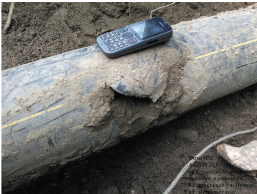
Рис. 19. Авария на предприятии АО «Газпром газораспределение Петрозаводск»
