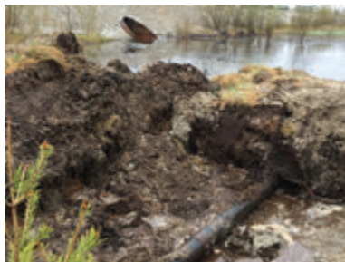
Рис. 12. Место разгерметизации меж-промышленного трубопровода
