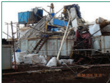
Рис. 9. Разрушение мачты установки МБС ИДЕЛЬ-125
