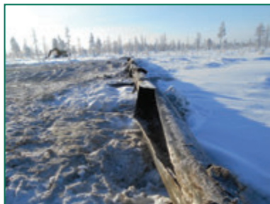
Рис. 8. Последствия разгерметизации промышленного трубопровода ООО «РН-Пурнефтегаз»
