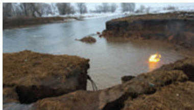
Рис. 3. Авария на магистральном газопроводе «Оренбургский ГПЗ — Совхозное ПХГ»
