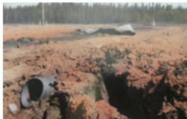
Рис. 7. Авария на магистральном газопровode «Ямбург — Елецк 1»
