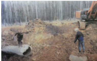
Рис. 5. Авария на магистральном газопровode «Белоусово-КГМО»
