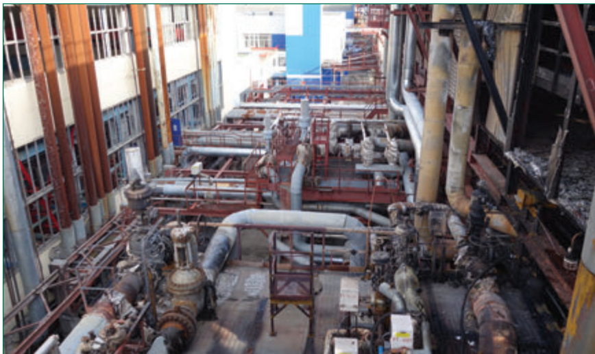
Рис. 6. Авария в ОАО «Метафракс»
