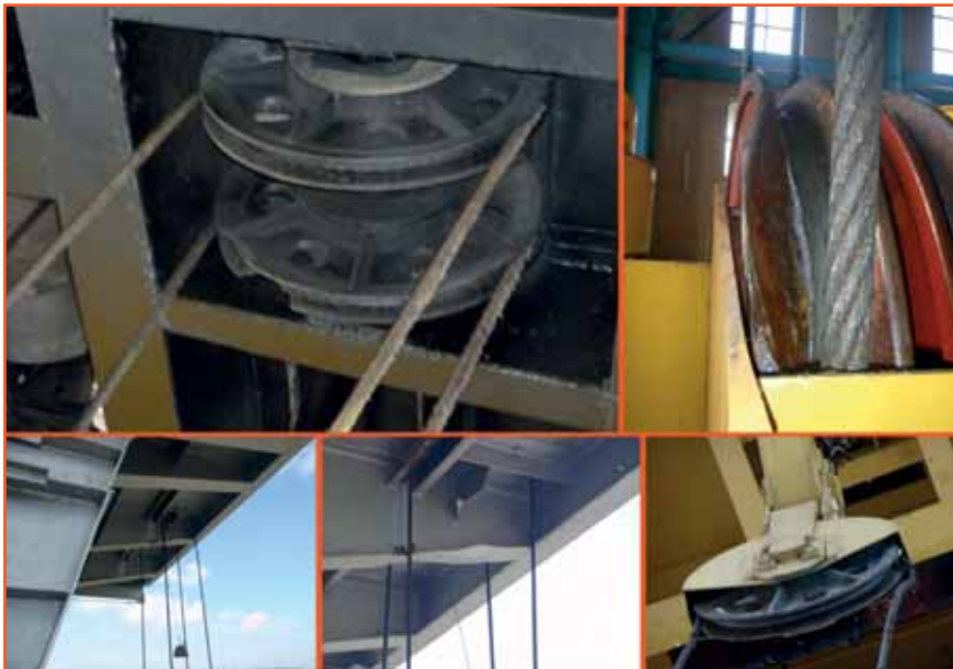
Рис. 1. Последствия несрабатывания концевого выключателя
