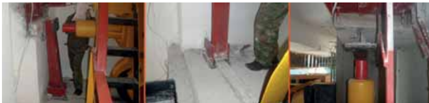
Рис. 2. Деформации тупиковых упоров
