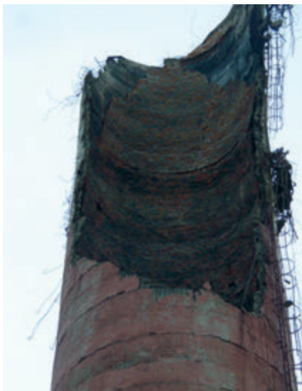
Рисунок. Общий вид дымовой трубы после обрушения
