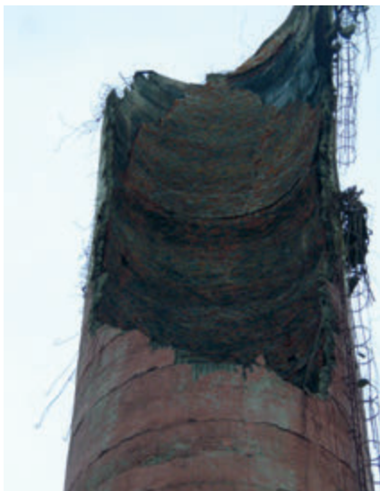
Рисунок. Общий вид дымовой трубы после обрушения
