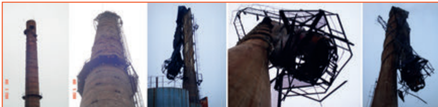
Рис. 1. Виды разрушений дымовых труб
