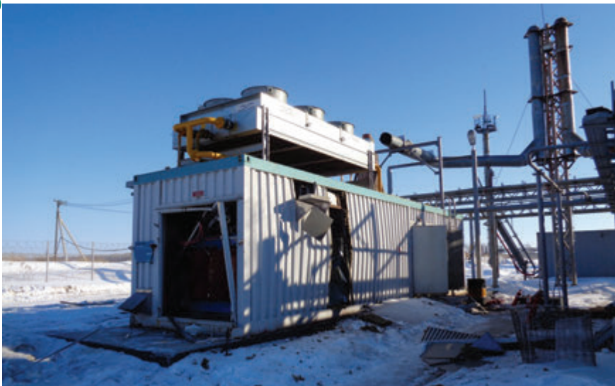
Рис. 29. Последствия аварии в ЗАО «САНЕКО»
