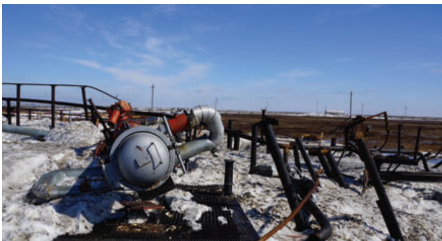
Рис. 31. Последствия аварии на узле приема очистного устройства ООО «Газпром добыча Ямбург»
