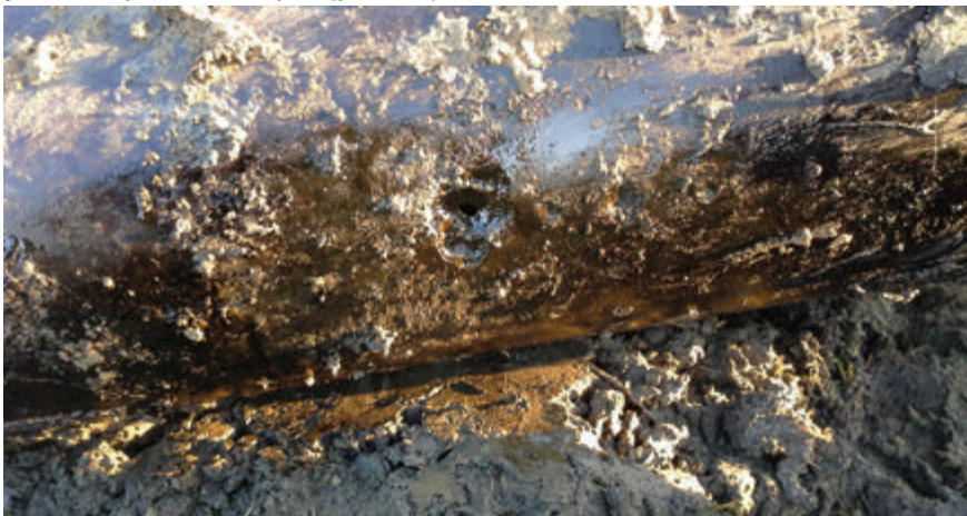
Рис. 24. Коррозия тела нефтепровода ООО «РН-Краснодарнефтегаз»
