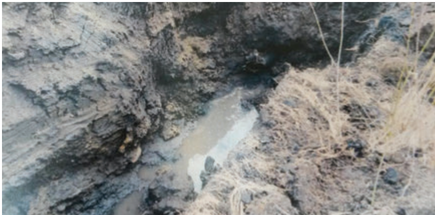
Рис. 21. Авария на газопроводе–отводе к газораспределительной станции «Алатырь»
