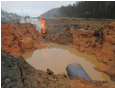
Рис. 18. Авария на магистральном газопроводе Торжок–Долина
