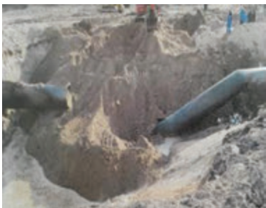
Рис. 19. Авария на магистральном газопроводе «Уренгой–Новопсков 1»
