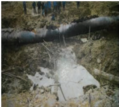
Рис. 20. Авария на магистральном газопроводе «Уренгой–Центр 1»
