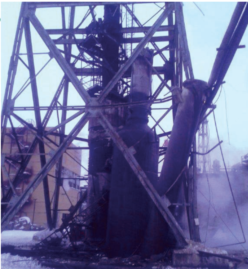
Рис. 1. Авария на факельной установке для сжигания газов в филиале «Азот» ОАО «ОХК «УРАЛХИМ»
