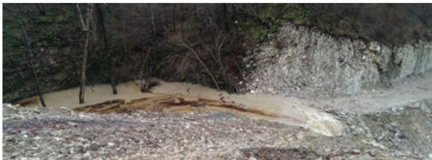
Рис. 57. Сход оползня при строительстве магистрального нефтепровода
