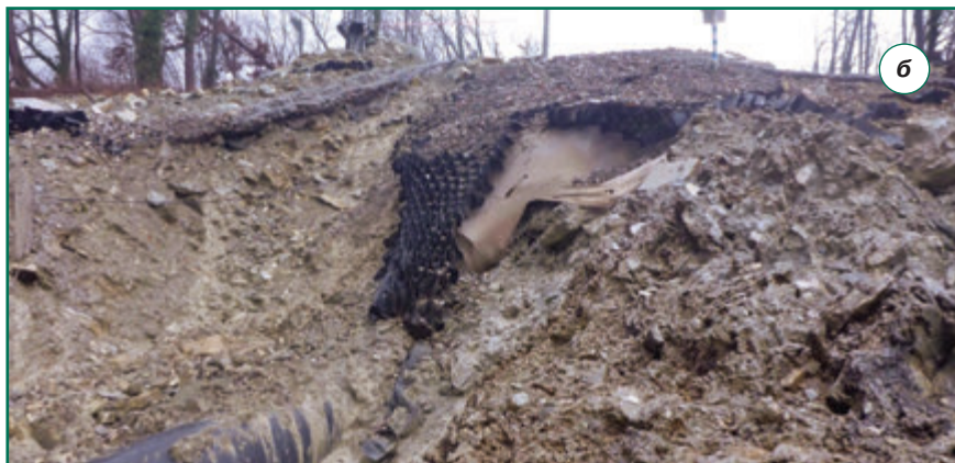
Рис. 58. Участок поврежденного магистрального нефтепровода
