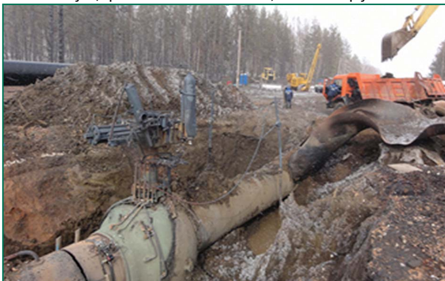
Рис. 14. Общий вид разрушения трубной секции магистрального газопровода «Челябинск–Петровск»
