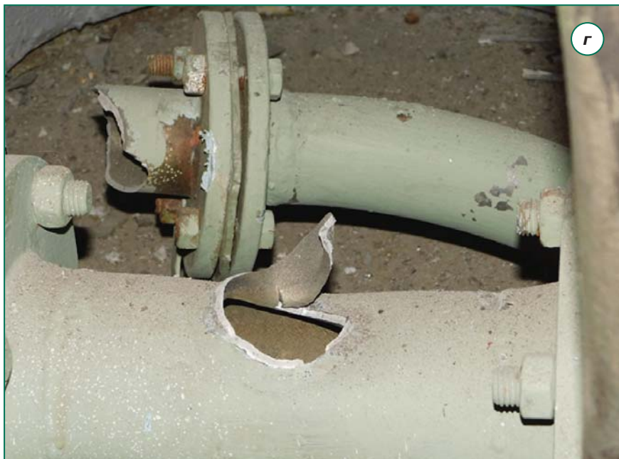
Рис. 3, а–г. Последствия взрыва во время проведения сварочных работ при реконструкции здания ФГУП «Завод имени Морозова»
