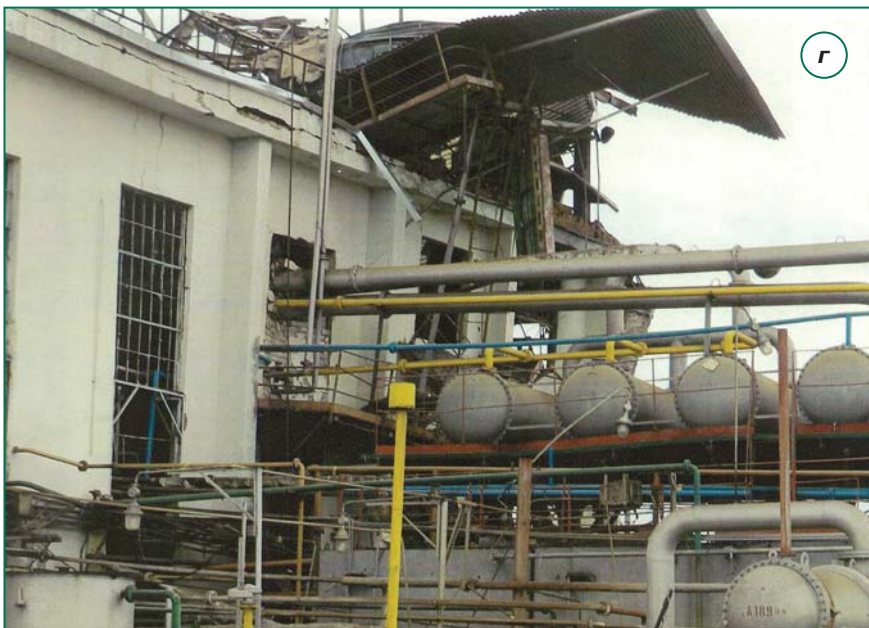
Рис. 2, а–г. Виды строительных конструкций здания после взрыва в производственном помещении экстракционного цеха филиала «Завода по экстракции растительных масел» ООО «Маслоэкстракционный завод Юг Руси»
