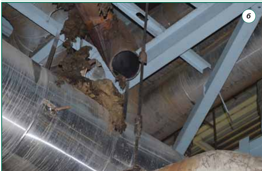
Рис. 26, а, б. Место разрушения паропровода греющего пара блока №2 филиала ПП «Самарская ТЭЦ» ОАО «Волжская ТГК»
