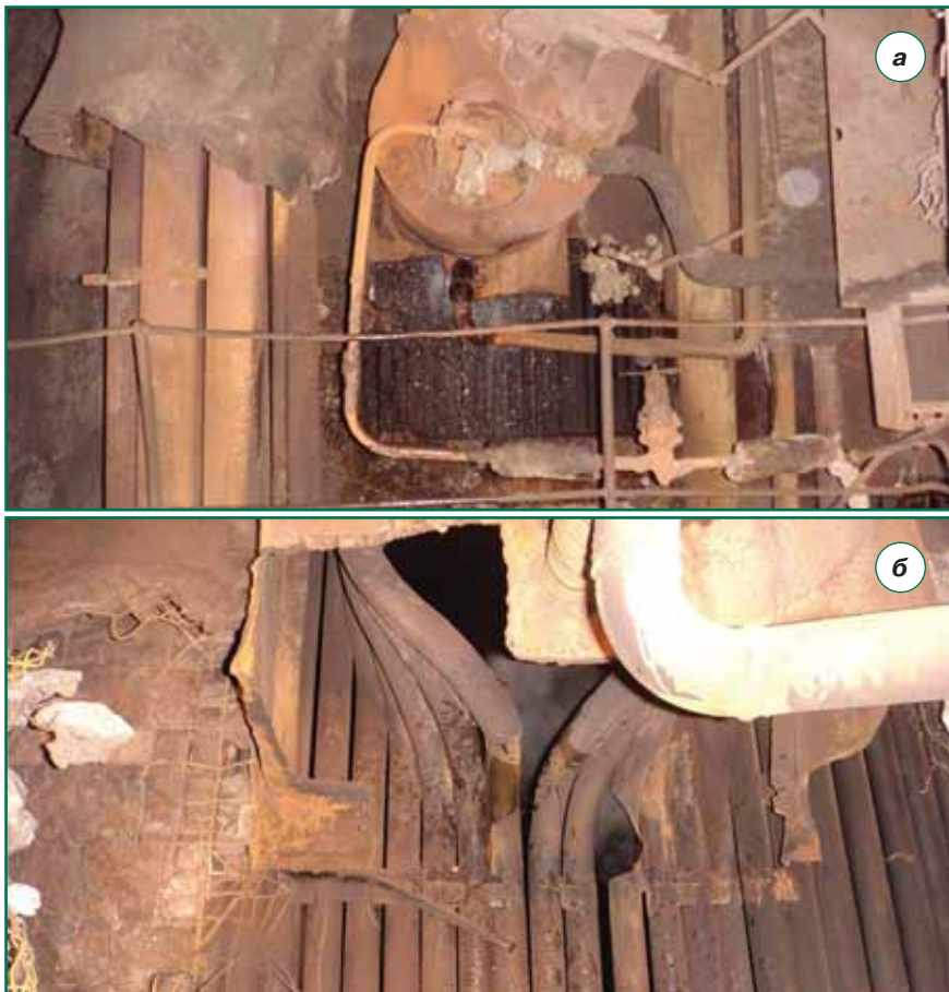
Рис. 28, а, б. Вид на место разрыва экранных труб под мазутной форсункой левого экрана котла БКЗ-210-140-8
