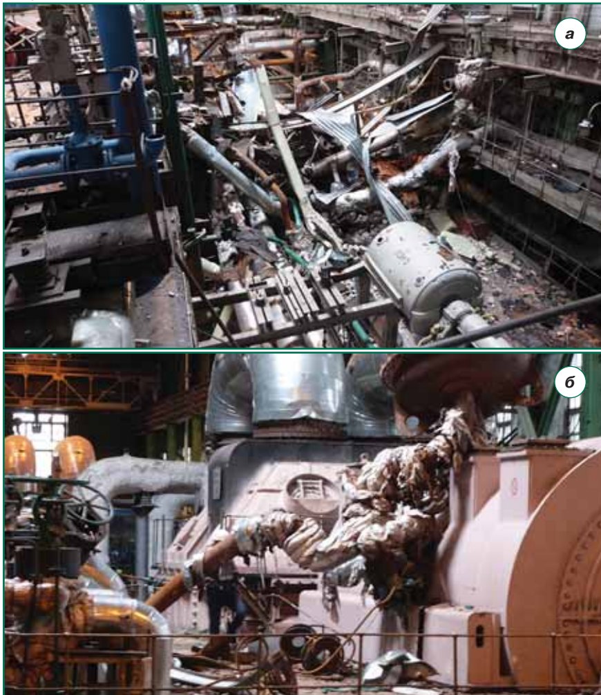
Рис. 27, а, б. Виды последствий аварии подогревателя высокого давления № 7 в машинном зале энергоблока № 2 филиала ОАО «ИНТЕРРАО-Электрогенерация» Черепецкой ГРЭС
