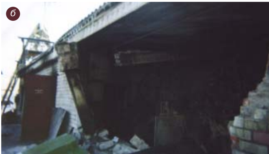
Рис. 5, а–в. Разрушения от взрыва на пункте подготовки вагонов к перевозкам вагонного депо Бологое Октябрьской железной дороги
