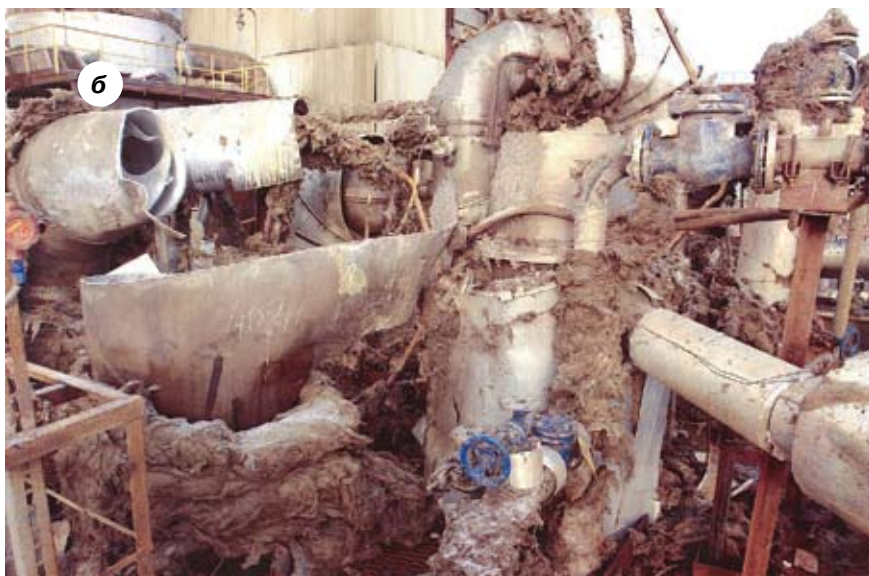
Рис. 1. Последствия аварии в ЗАО «Завод минеральных удобрений Кирово-Чепецкого химического комбината»: повреждённая колонна синтеза (а), разрушенный трубопровод (б)
