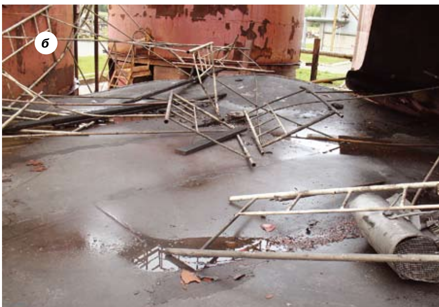
Рис. 2, а и б. Разрушения от взрыва пылевоздушной смеси в ОАО «Группа «Илим»
