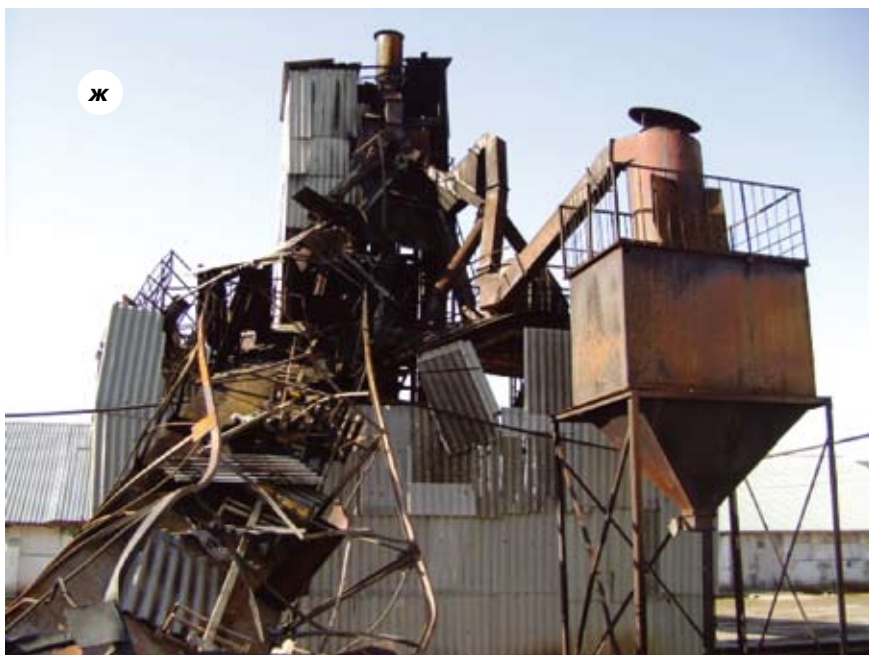
Рисунок, а–ж. Последствия аварии в ОАО «Георгиевский элеватор»: а – вид на торцевую стену зерносклада № 8 с юго-западной стороны; б – вид на башмак нории НЦ-100; в – вид на зерносклад № 12; г – зерносклад № 15, угол склада с северо-восточной стороны; д – зерносклад № 15; е – самоходный шнековый погрузчик; ж – вид с западной стороны на приёмно-отпускное устройство
