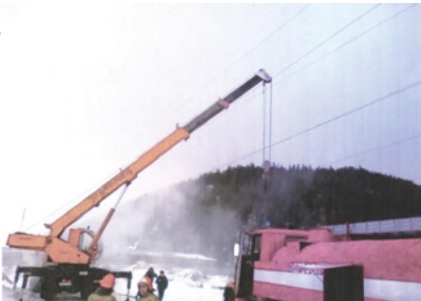
Рис. 1. Место несчастного случая при работе автомобильного крана MKT-25 вблизи ЛЭП (ООО «Актив Констракшн»)
