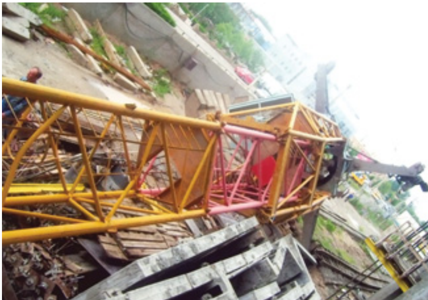
Рис. 5. Последствия аварии башенного крана КБ-403 в ОАО «СПМК-39»
