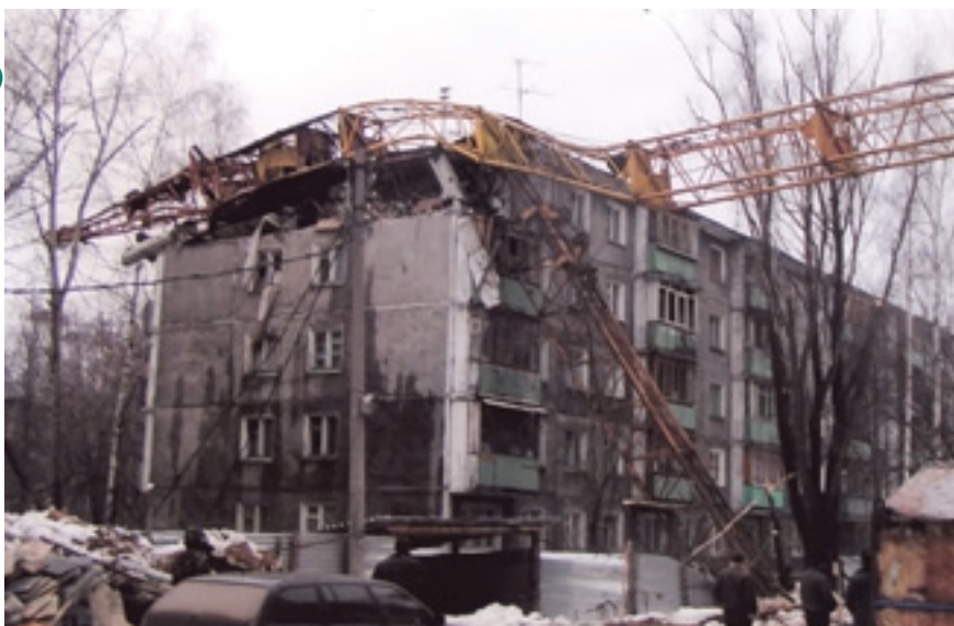
Рис. 3. Место и последствия аварии башенного крана КБМ-401П в ООО «ЕФТО»
