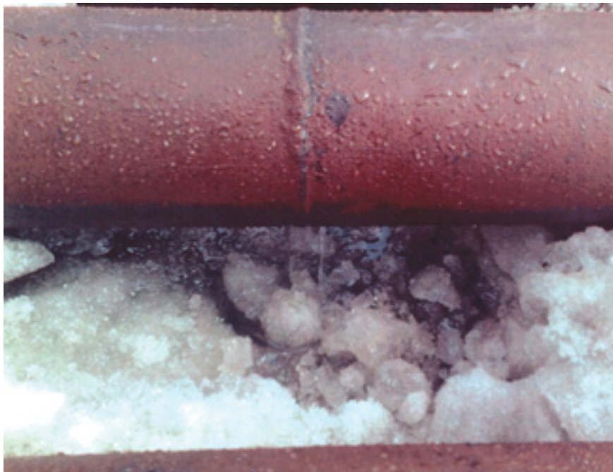
Рис. 3. Место истечения продукта из технологического трубопровода на Норильской нефтебазе (ЗАО «Таймырская топливная компания»)
