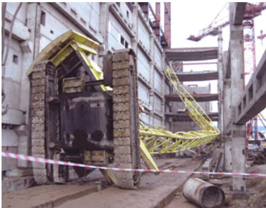
Рис. 7. Последствия аварии (падение гусеничного крана СКГ-631) в ООО СпецСтальМонтаж»
