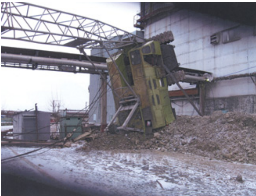
Рис. 1. Место аварии гусеничного крана РДК-250-2 в ЗАО «СИБ РМСУ»
