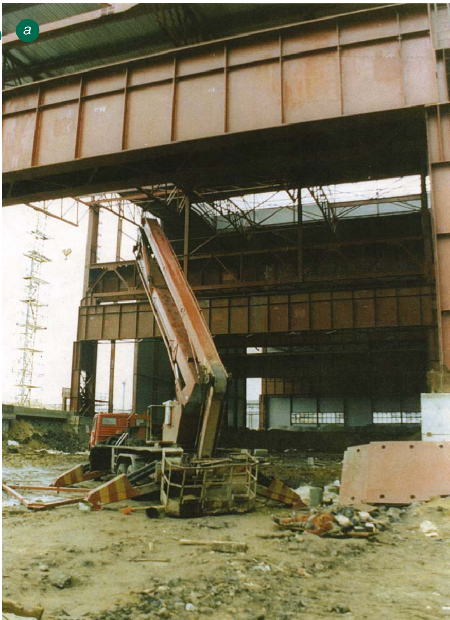
Рис. 8. Авария автогидроподъемника Бронто-Скайлифт 30-3: а, б – место несчастного случая
