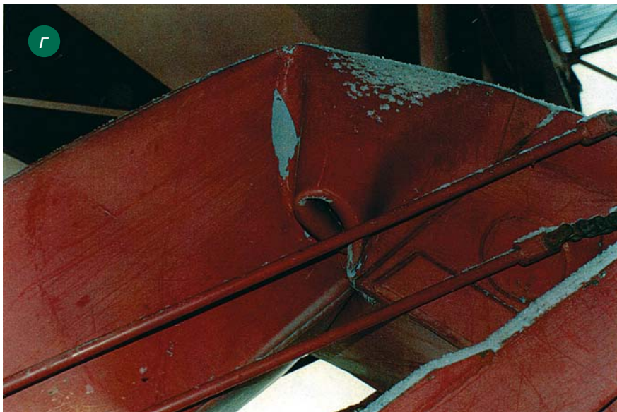
Рис. 8. Авария автогидроподъемника Бронто-Скайлифт 30-3: в, г – место деформации стрелы
