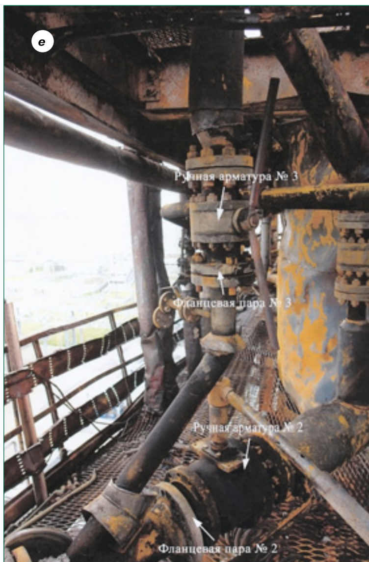
Рис. 3. Место аварии в ООО «Ставролен»: а – общий вид реактора после пожара; б – полная деформация металлоконструкций и решёток площадки; в – частичная деформация металла трубопроводов обвязки реактора (отметка 17 м); г – разрушение металлоконструкций площадок обслуживания и силовых конструкций металлического каркаса реактора; д и е – система выгрузки PDS-1 реактора после аварии
