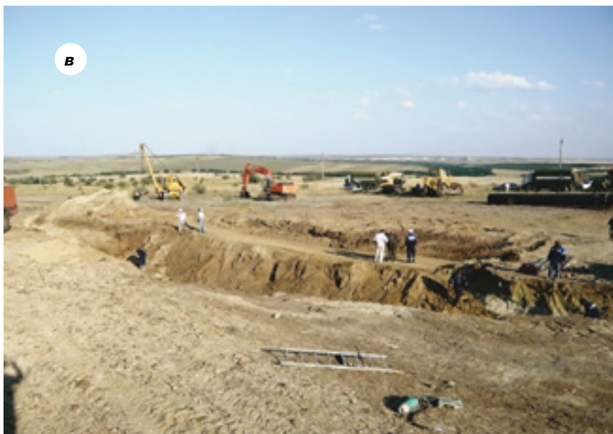
Рис. 2. Место аварии на магистральном газопроводе «Средняя Азия–Центр-III»: а и б – разрушенный газопровод; в – ликвидация последствий аварии
