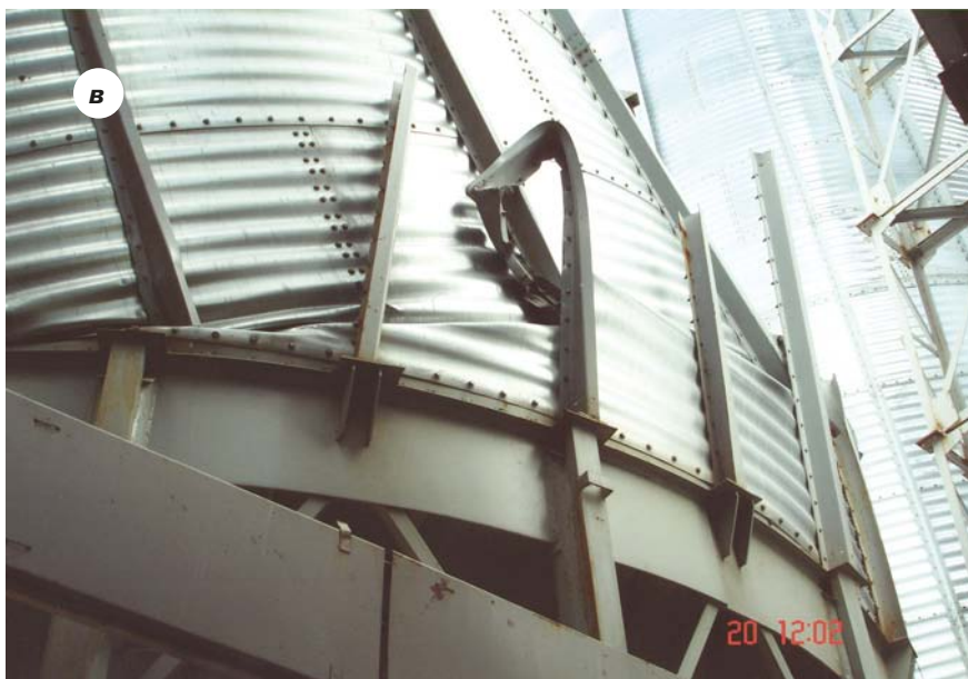
Рис. 4. Разрушение нижнего пояса металлического силоса в ГУП РК «Птицефабрика «Зеленецкая»: а – деформация корпуса силоса № 28 в районе 2-го яруса; б – состояние силоса после освобождения его от зерна; в – деформация стоек несущего каркаса
