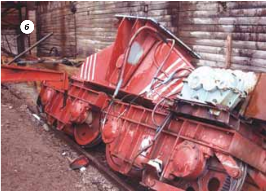
Рис. 5. Последствия аварии башенного крана КБГС-450 (а); передняя правая ходовая тележка крана с механизмом передвижения (б)
