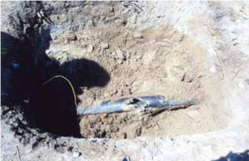
Рис. 4. Газопровод ОАО «Сибирьгазсервис», поврежденный при земляных работах в ООО «Бердская птицефабрика «Алмаз»
