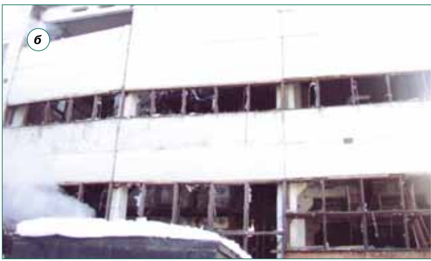
Рис.1, а и б. Здание котельной в ФГУП «Пермский завод «Машиностроитель», поврежденное при аварии
