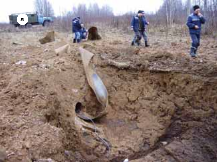
Ρис. 2. Последствия аварии на 40-м км газопровода-отвода к ГРС «Гагарин»: разрушенный участок газопровода (α) и его фрагмент (β); образовавшийся после аварии котлован (β)
