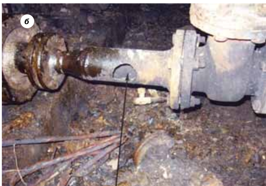
Рис. 2. Повреждение оборудования в результате аварии в ОАО «Стерлитамакский нефтехимический завод»: а – место разрыва трубопровода нагнетания насоса поз. 35/2; б – место разрыва на всасывающем трубопроводе насоса поз. 35/2
