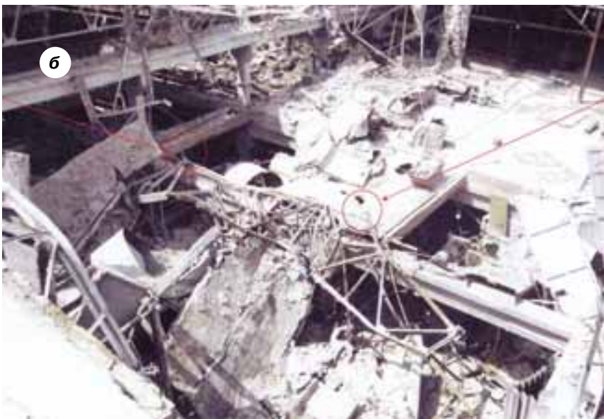
Рис. 7. Место обрушения покрытия здания в ОАО «Омский каучук»: а – общий вид здания цеха Е-2 в осях А-Е/10-13; б – разрушенная ферма в осях А-Е/11
