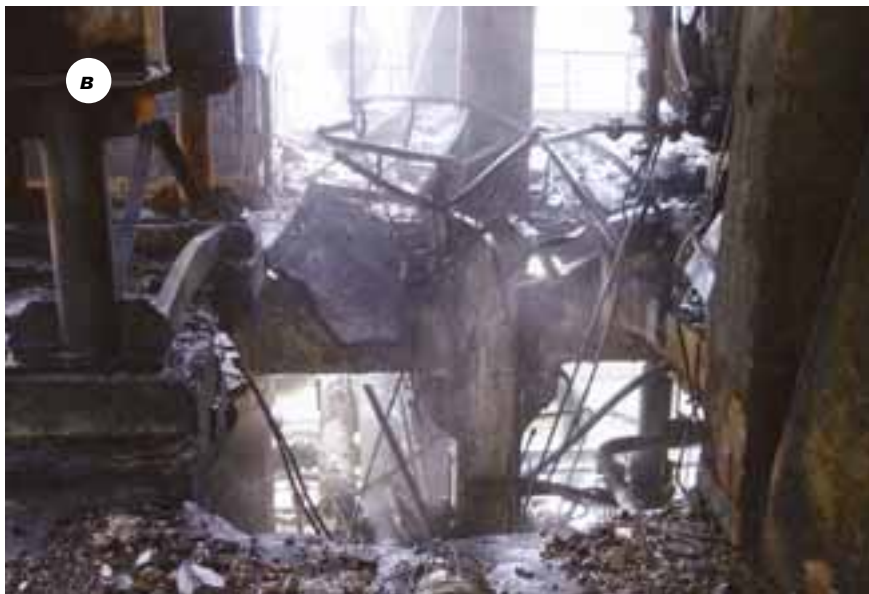
Рис. 9. Последствия аварии в ОАО «Уфимский НПЗ»: а – место разрыва трубы; б и в – отметки 6 и 12 м соответственно
