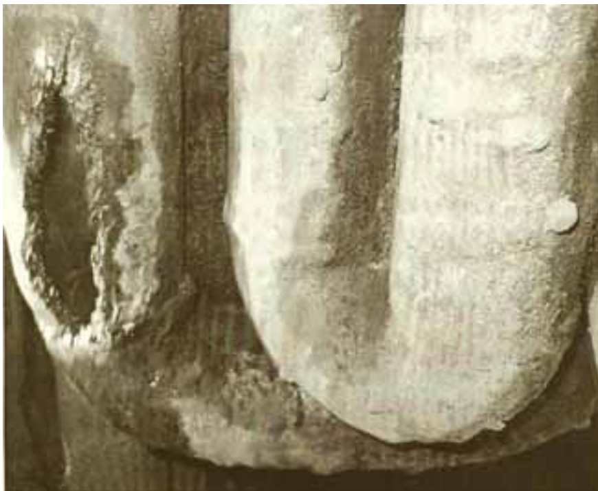
Рис. 2. Разрыв труб водоохлаждаемой панели печи в ЗАО «Нижнесергинский метизно-металлургический завод
