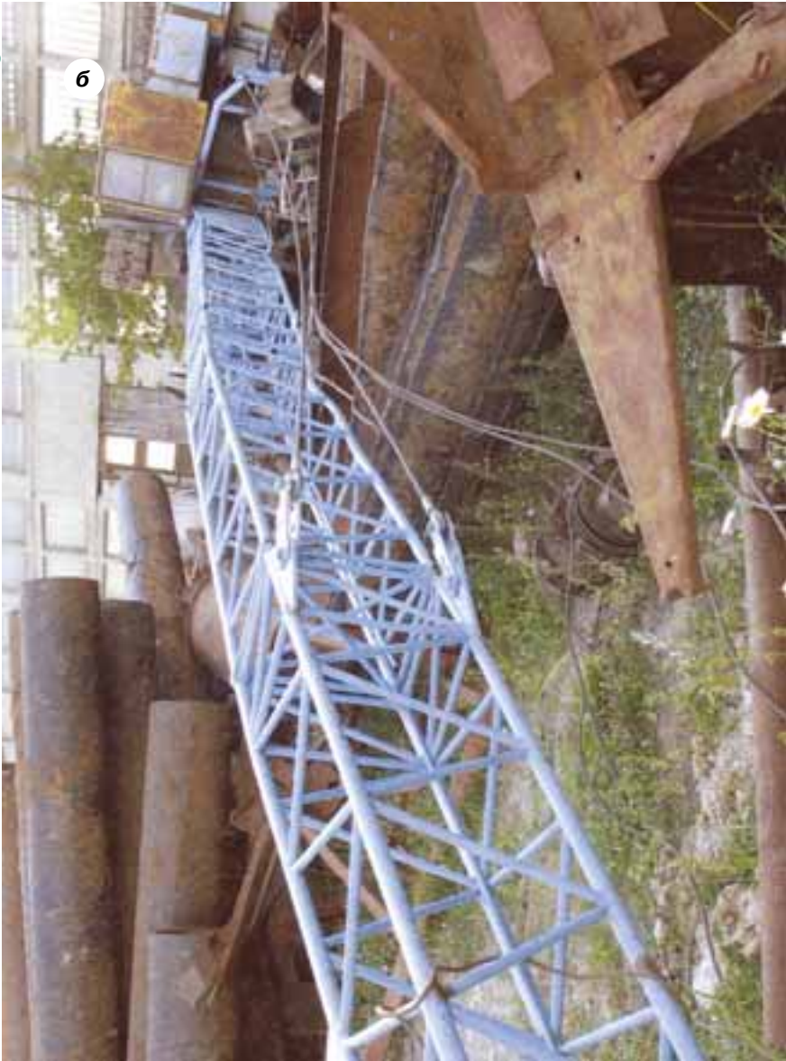
Рис. 7, а и б. Место аварии гусеничного крана РДК 160-2 (а) и последствия аварии (б)
