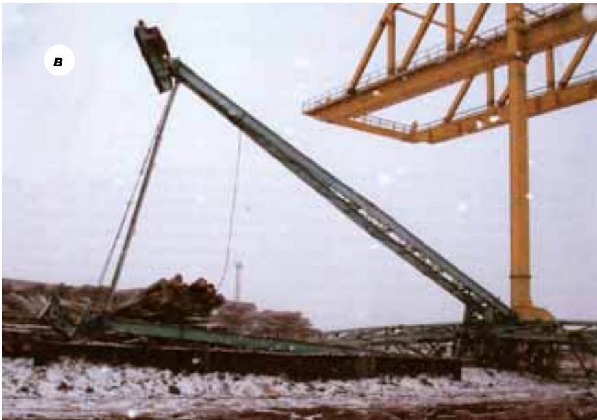
Рис. 8, а–в. Схема места аварии козлового крана КСК-30-42В (а); разрушенный противоугонный захват крана КСК (б); место аварии (в)
