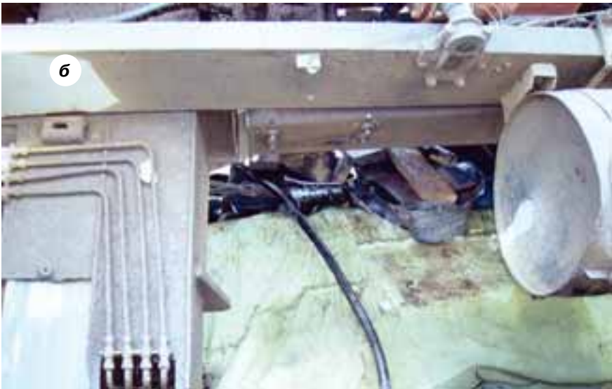
Рис. 3, а и б. Последствия аварии автомобильного крана МКАТ-20: а – вид крана после аварии; б – место аварии
