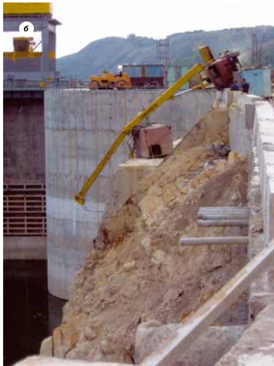
Рис. 6, а и б. Вид автомобильного крана КС-3571-1 после аварии (а) и место аварии (б)
