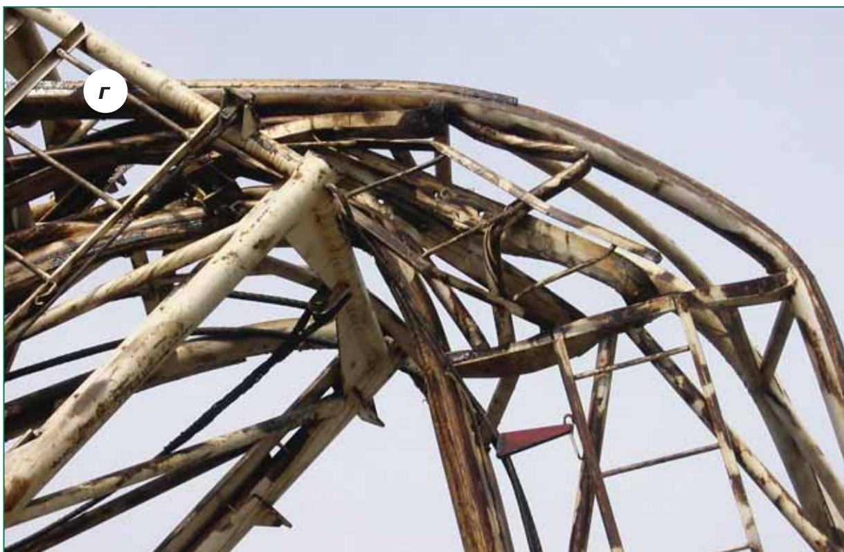
Рис. 2, а–г. Последствия аварии на скважине № 2921 Талинского месторождения: а и б – аварийный подъемник (общий вид); в – якоря оттяжек, расположенные с нарушением схемы (видно отсутствие стяжных винтов на фундаментной балке); г – сломанная мачта подъемника
