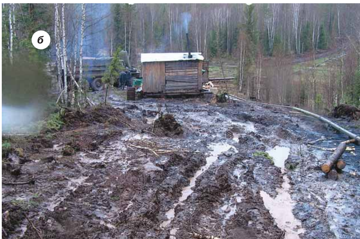
Рис. 1. Место аварии на нефтепроводе ПМТП-150 «Верхне-Марково–Усть-Кут»: а – нарушенное крепление трубы; б – разлив нефти
