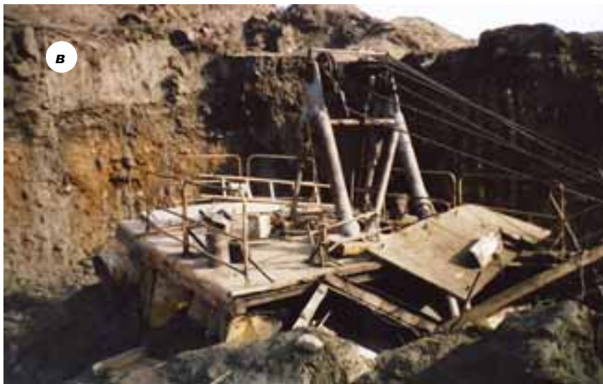
Рис. 2, а–в. Последствия обрушения борта карьера в ЗАО «Маракан»: а – место оползания борта; б – положение экскаватора после оползания борта; в – место несчастного случая
