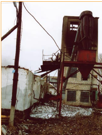
Рис. 5. Норийная башня приемной точки № 10 после пожара (вид с восточной стороны)
