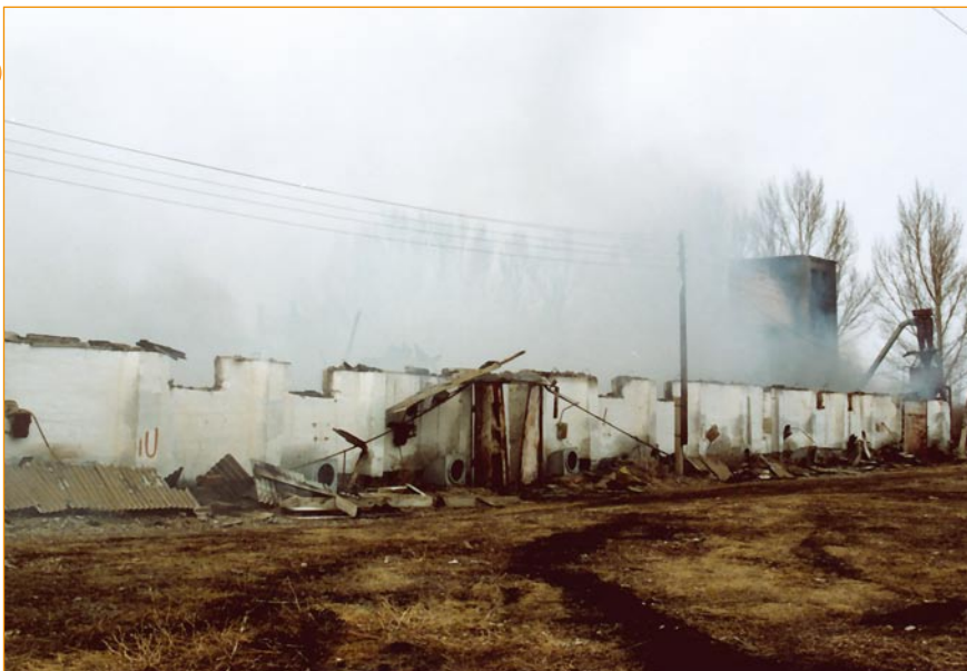
Рис. 4. Зерносклад № 10 после пожара (вид с юго-восточной стороны)
