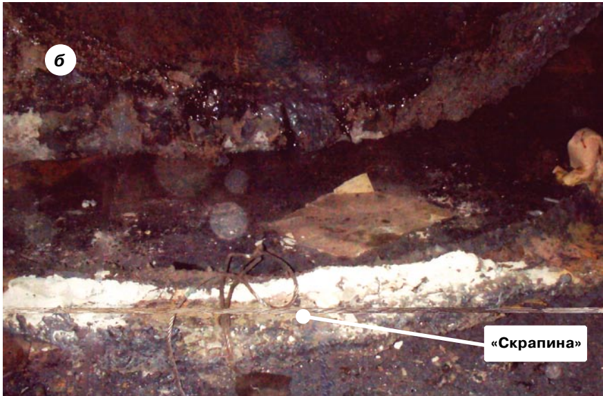
Рис. 2. Место несчастного случая в мартеновском цехе ОАО «Уральская сталь»: части ковша: а – верхняя; б – нижняя
