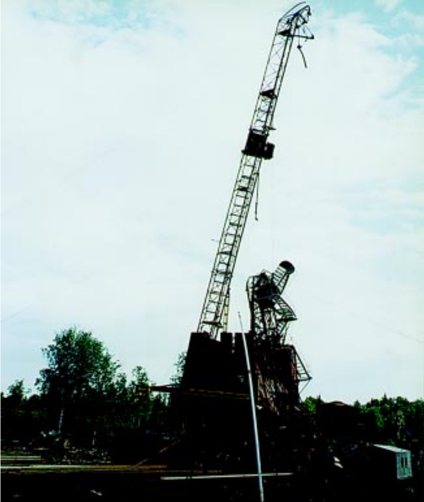
Рис. 2, а. Разрушение буровой вышки БУ-1600
