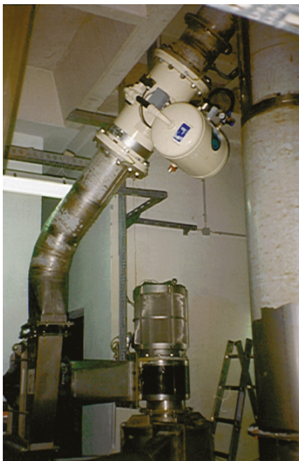
Быстродействующая система ЕХКОР с взрыворазрядным устройством ECO-Q-Rohr ДН 200, гасящий вентиль DN 250 на циклоне для пластиковых гранул
