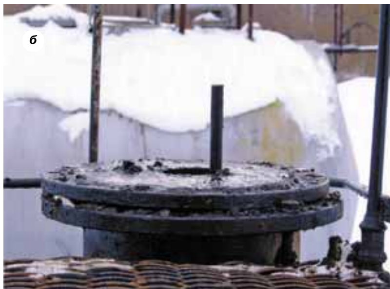
Рис. 1, а и б. Последствия возгорания углеводородного газа при проведении сварочных работ на крыше резервуара в ООО «СпецКриТ»
