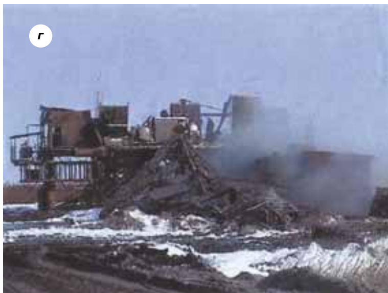
Рис. 5. Открытый газоконденсатный фонтан на скважине № 5 (Восточно-Прибрежное месторождение) филиала «Кубаньбургаз» ДОО «Бургаз»: а, б – начальная стадия аварии; в – вид буровой установки до снятия вышки; г – буровая установка после снятия вышки
