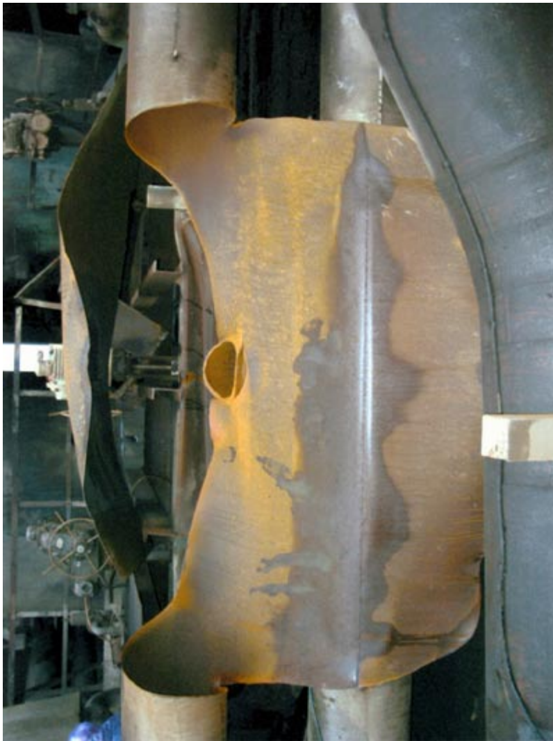
Рис. 4. Кислородопровод после аварии (ОАО «Северсталь»)
